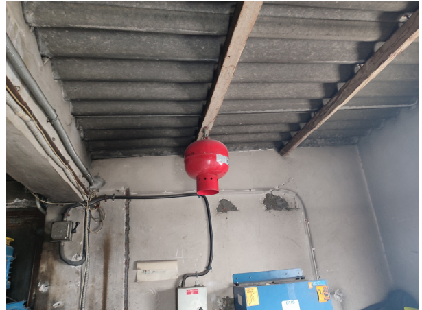
Εικ. 3 Πλευρά τοιχοποιίας μηχανοστασίου ανελευστήρα 1, εμφανίζονται μικρές φθορές στα επιχρίσματα και φύλλο αμιάντου στην οροφή .
