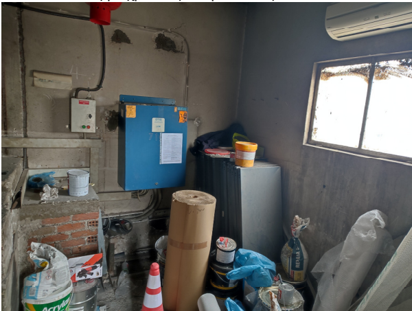
Εικ. 2 Πλευρά τοιχοποιίας μηχανοστασίου ανελευστήρα 1, εμφανίζονται μικρές φθορές στα επιχρίσματα.
