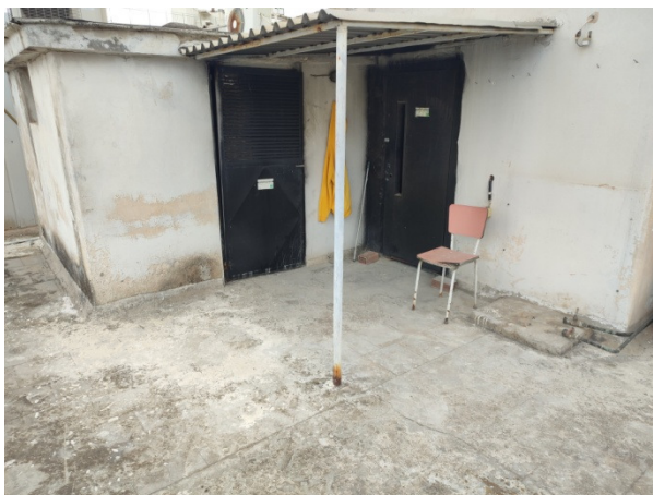
Εικ. 7 Εξωτερικές πλευρές μηχανοστασίων ανελκυστήρα.
