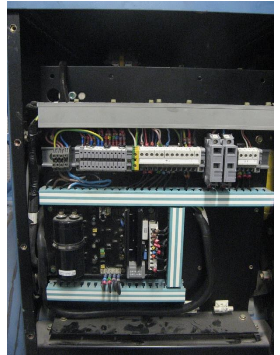
Φωτογρ.6: Ρυθμιστής Τάσης και κλεμμοσειρά H/Z 1 (εντός του ερμαρίου ηλεκτρικών του H/Z)
