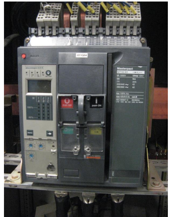
Φωτογρ.2 : Διακόπτης ισχύος H/Z I (εντός ηλ. πίνακα)
