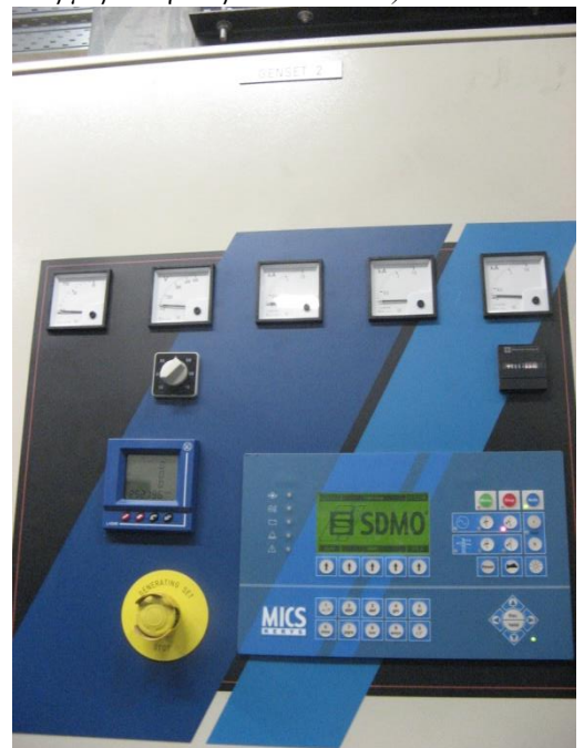
Φωτογρ.8: Πρόσσοψη Ηλ.Πίνακα H/Z 2
