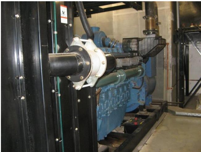
Φωτογρ.7: Ηλεκτροπαραγωγό ζεύγος 2
