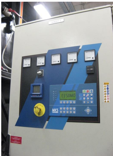
Φωτογρ.3: Πρόσωση Ηλ.Πίνακα H/Z I
