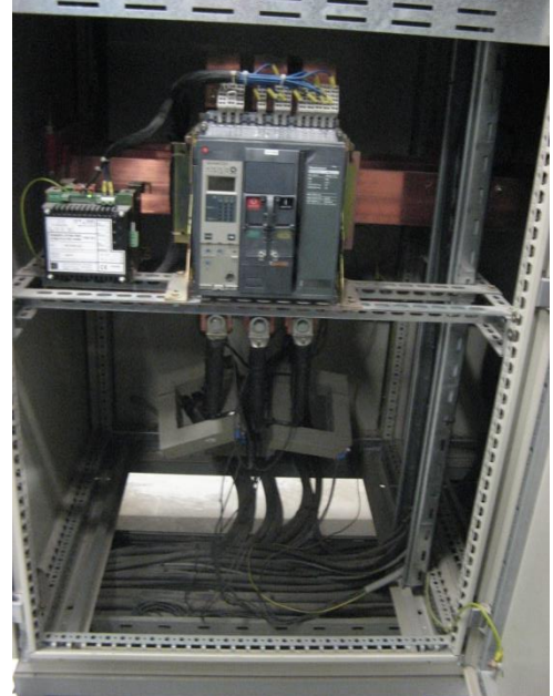
Φωτογρ.4: Ηλ.Πίνακας H/Z I
