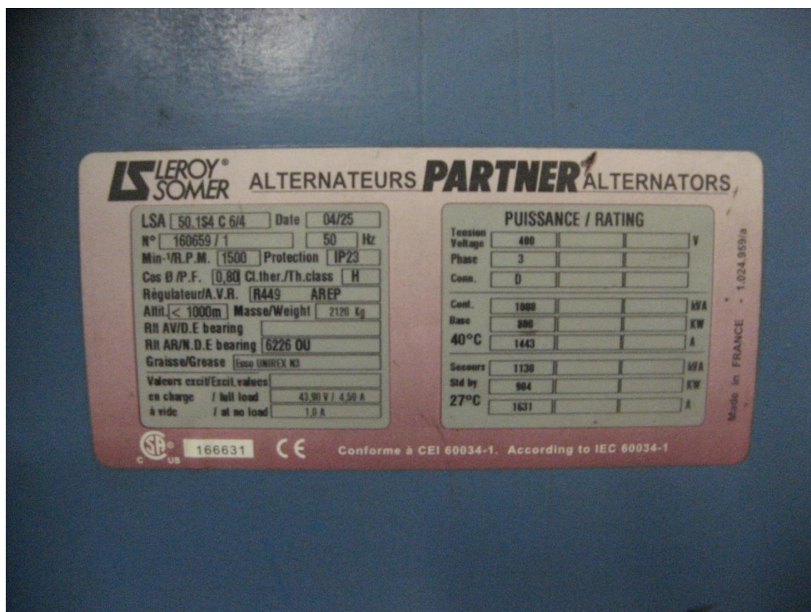
Φωτογρ.9: Ηλεκτροπαραγωγό ζεύγος (πινακίδα)
