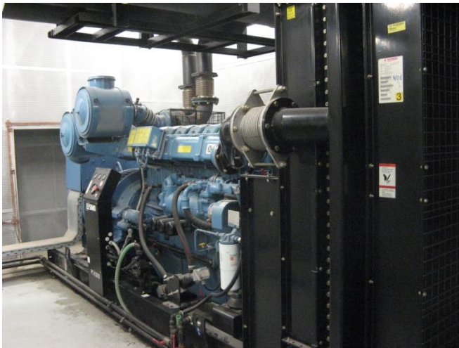
Φωτογρ.1 : Ηλεκτροπαραγωγό ζεύγος I
