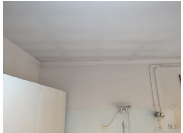
Εικ. 3 Εμφάνιση υγρασίας, έλεγχος της επιφάνειας με χτύπημα με κατάλληλο εργαλείο για εύρεση «κουφωμένων» τμημάτων
