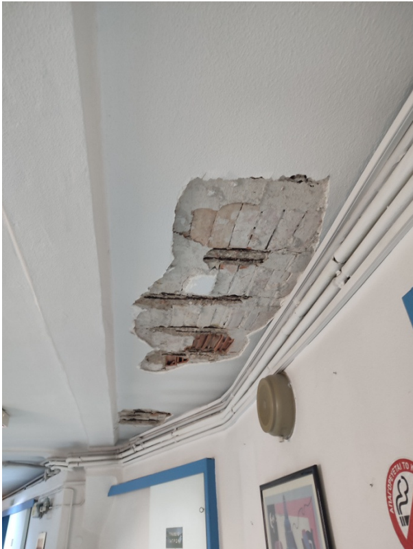
Εικ. 1 Αποκολλημένα επιχρίσματα και φθορές στον διάδρομο του οφθαλμολογικού
