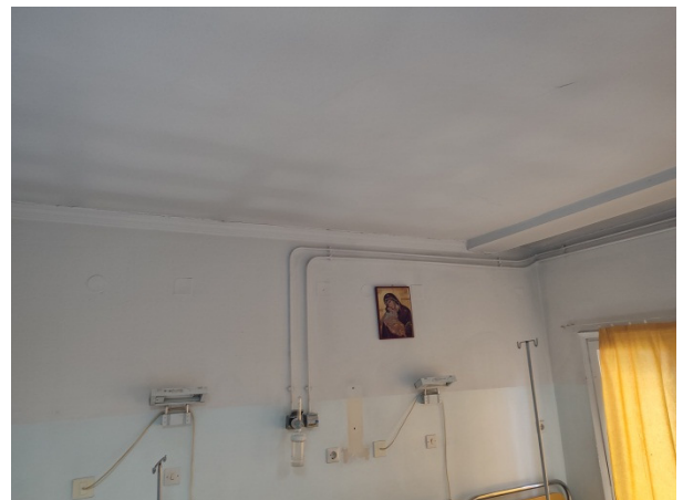
Εικ. 4 Εμφάνιση υγρασίας – έλεγχος για σαθρά τμήματα και αποκατάσταση και χρώσεις.
