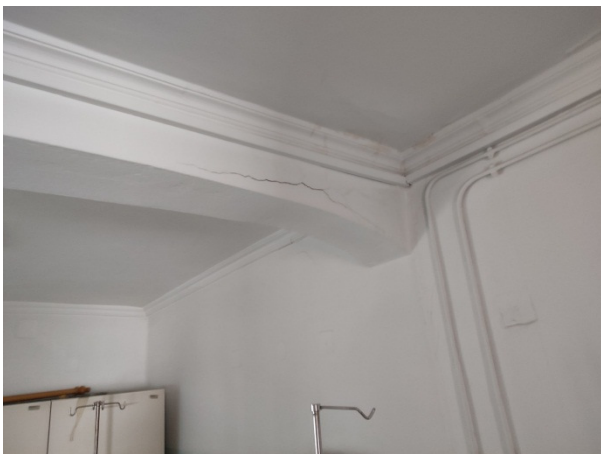
Εικ. 2 Ρωγμές σε δοκάρι έλεγχος και αποκατάστασή του.
